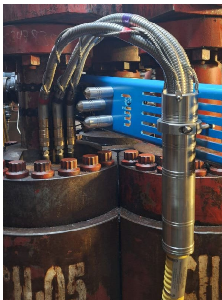
Imagen 5. Conector de superficie instalado en cabezal de pozo. Fuente: Reportes de operación
