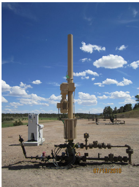
Imagen 3. Sistema de bombeo mecánico lineal (LRP®) controlado por un VFA dual. Fuente: UNICO Colombia, 2010.
