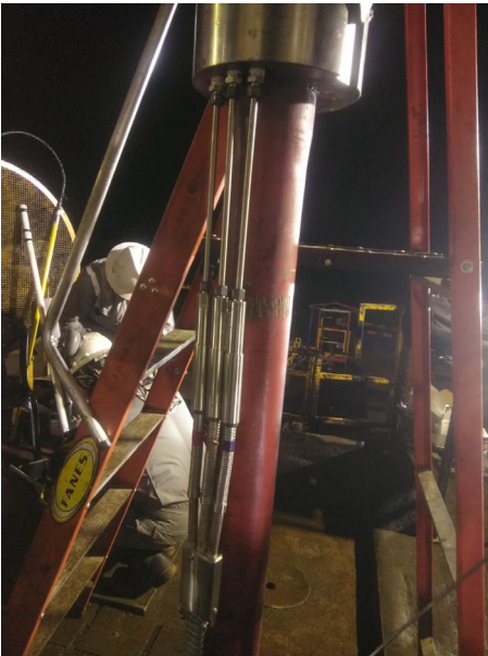
Imagen 3. SST instalados en los Splice Tubes Fuente: Reportes de operación
