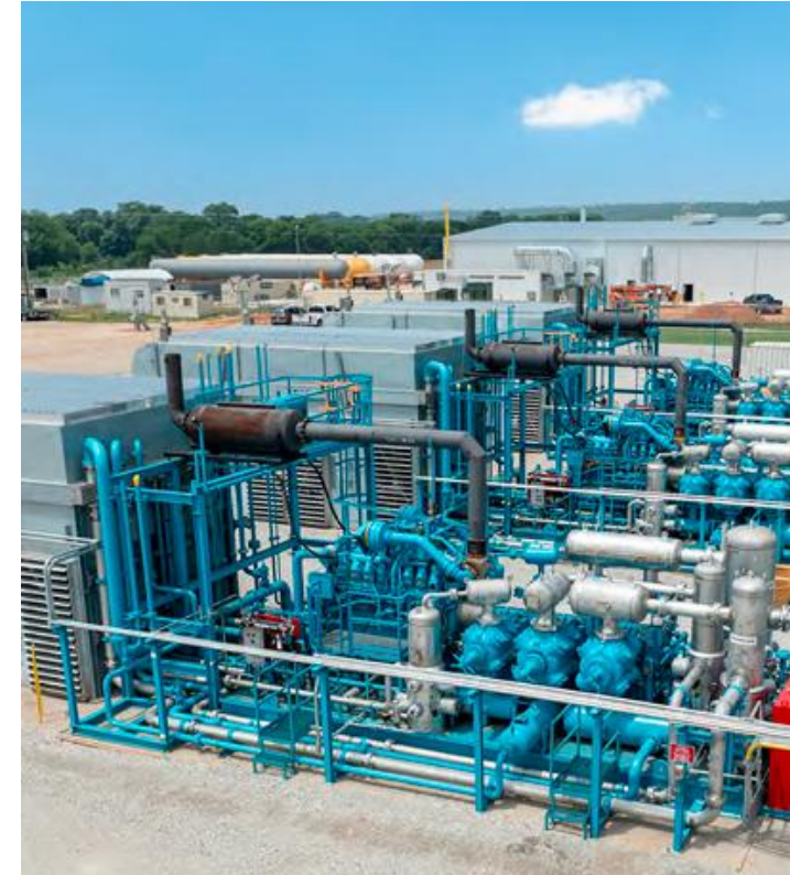
Estación de compresión de gas Fotografía cortesía de Enerflex
