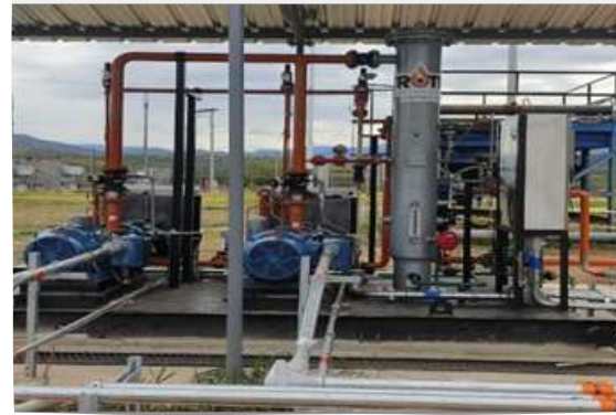
Acondicionamiento / Tratamiento del gas
