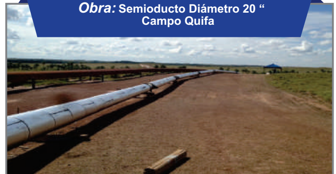
Obra: Semioleoducto Diametro 20" Campo Quifa
