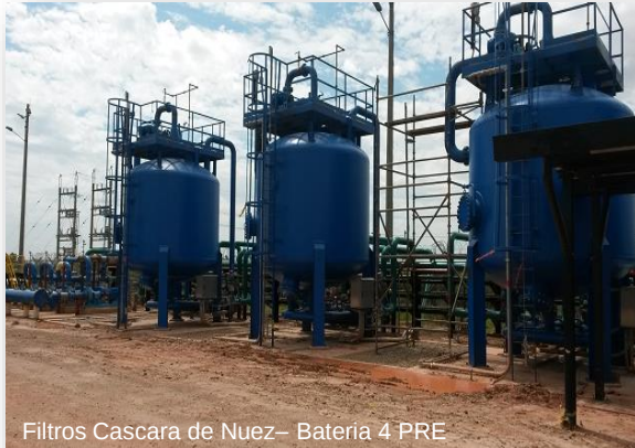
Filtros Cascara de Nuez– Bateria 4 PRE
