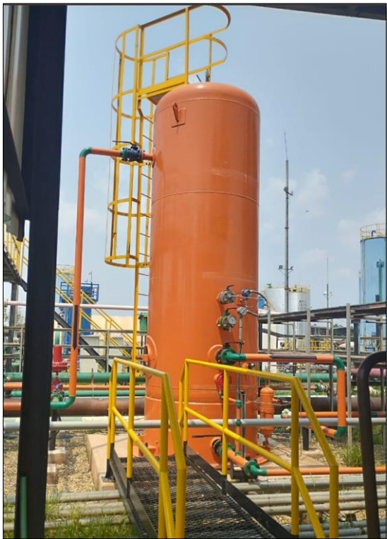
Tanque Pulmón 2.200 Gls Frontera Energy
