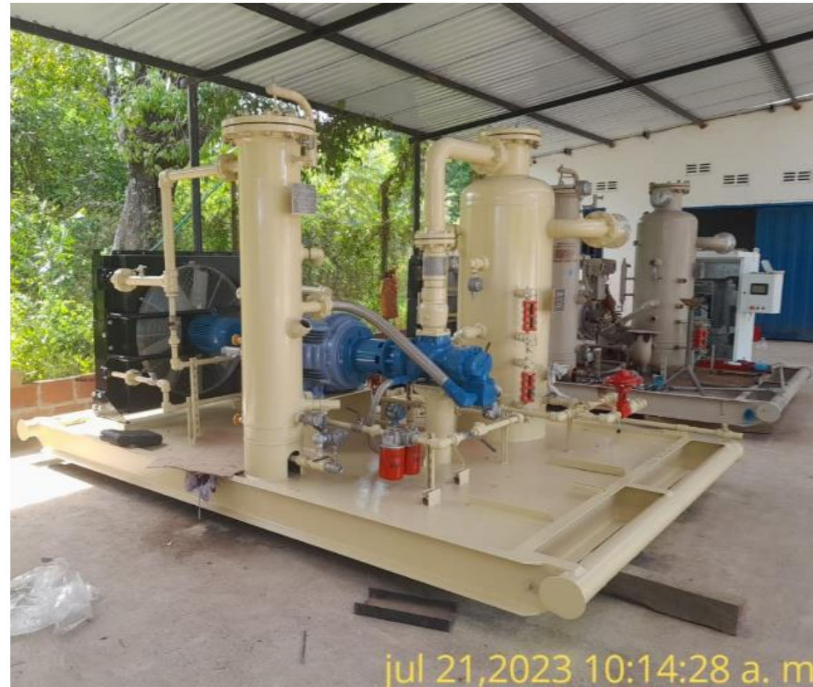
Compresor de gas
