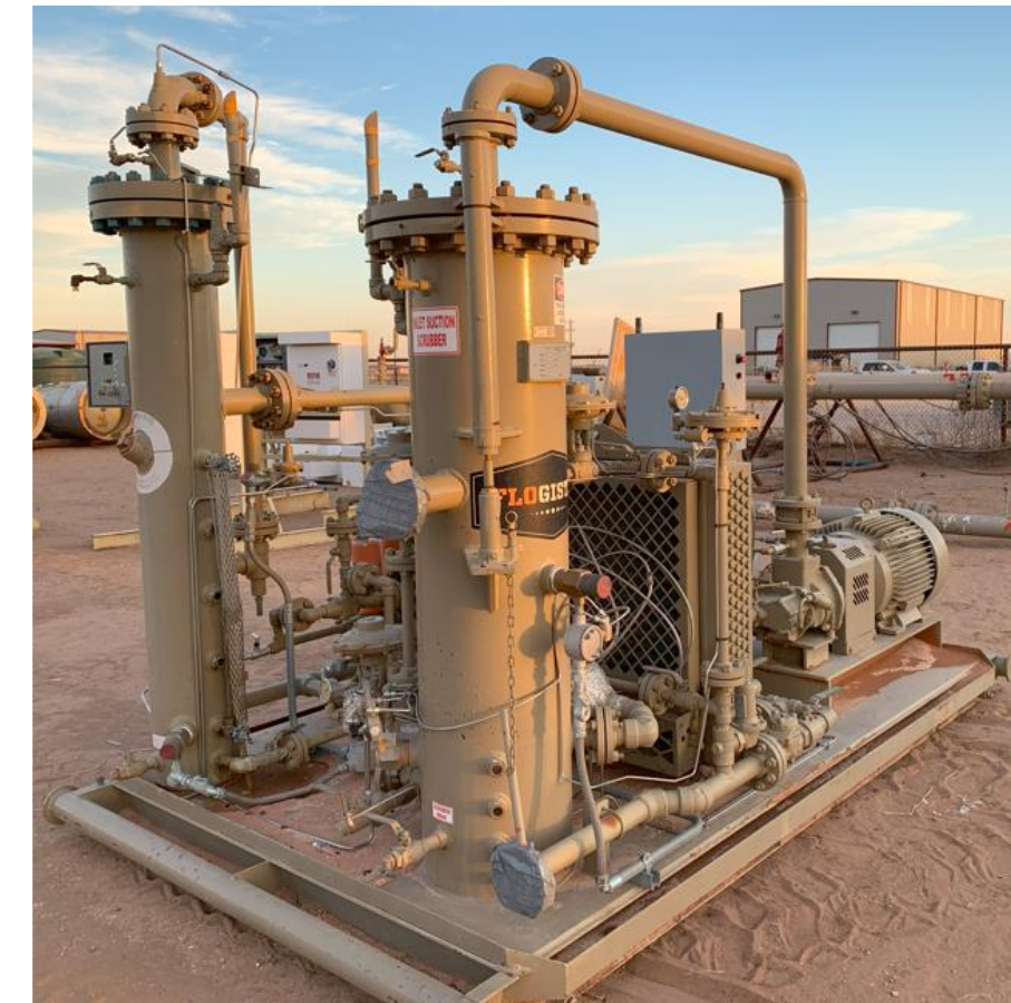
Compresor de gas
